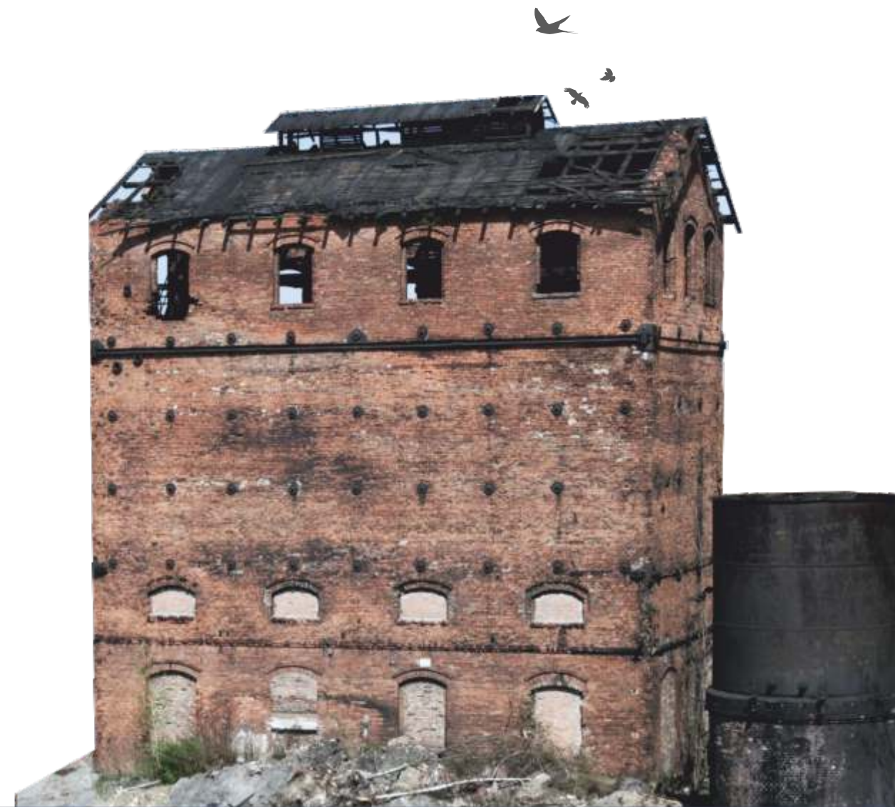
koksownia „Orzegów” 2018 "Orzegów" coke plant 2018
